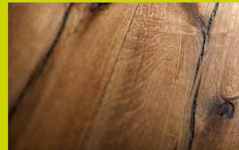
Not completely filled cracks and notches Fissures et nœuds pas complètement remplis
